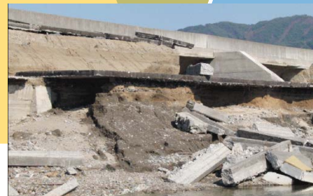
基礎地盤の洗掘
