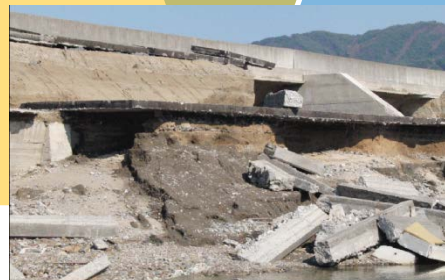
基礎地盤の洗掘
